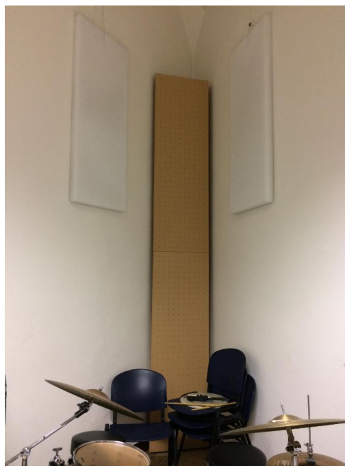
Foto 20: Aula 5: bass trapp pannelli a parete
