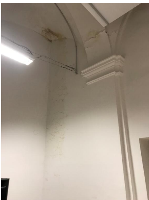
Foto 23: aula 5 segni di infiltrazioni d'acqua avvenute in passato
