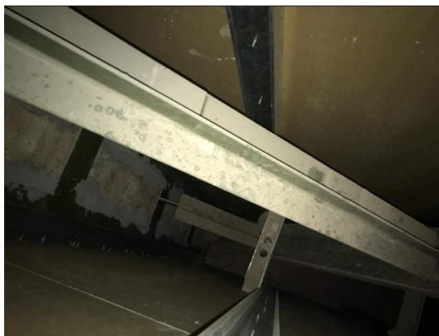
Foto 11: rinforzo strutturale esistente all'interno del cartongesso nella parete di separazione tra aule 2 e 3 e il corridoio
