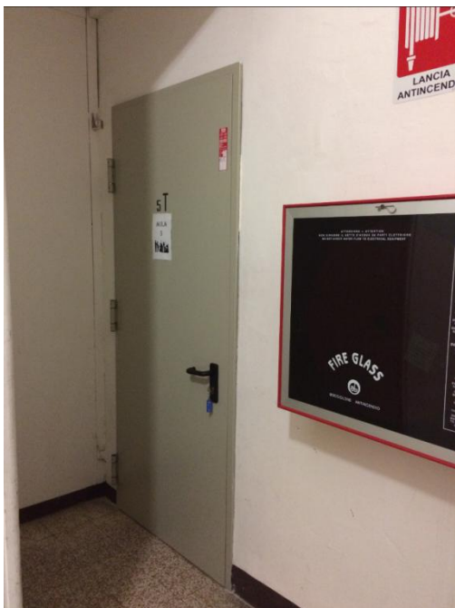
Foto 21: Porta REI120 aula 5 lato corridoio
