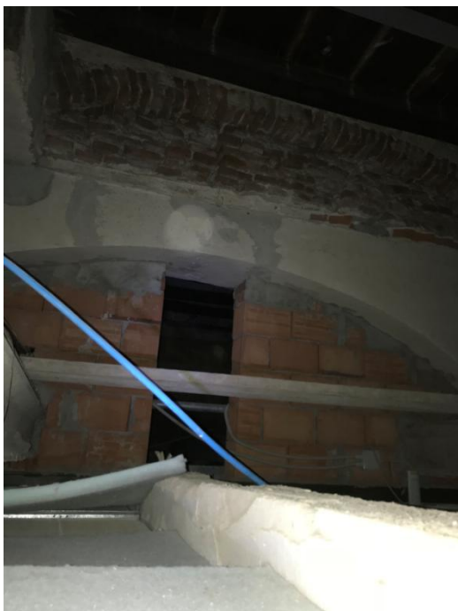
Foto 10: apertura regolare sopra parete aula 2 verso corridoio.
