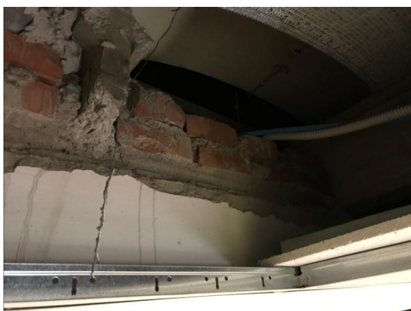
Foto 8 e Foto 9: varco irregolare sopra parete aula 1 verso reception.
